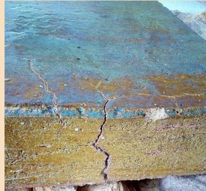
Figura 2 Grietas en el soporte por un deficiente moldeo. Fotografía: Rafa Galindo.
