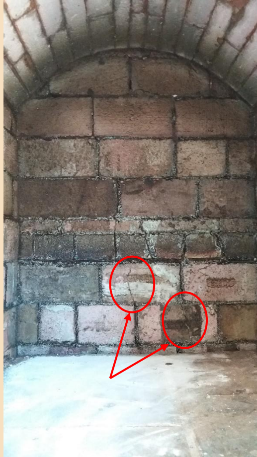
Figura 4. Grietas en ladrillos refractarios debidas a choque térmico. Fotografía: Rafa Galindo.
