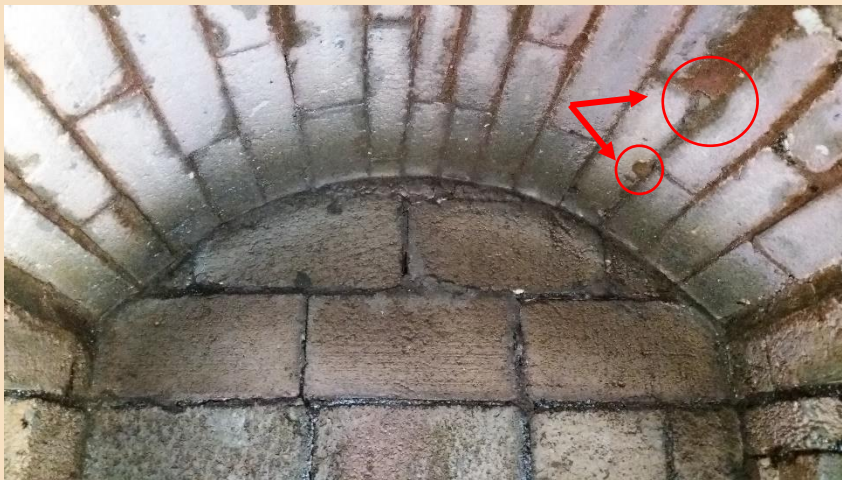
Figura 2. Refractario del techo deteriorado. Fotografía: Rafa Galindo. .
