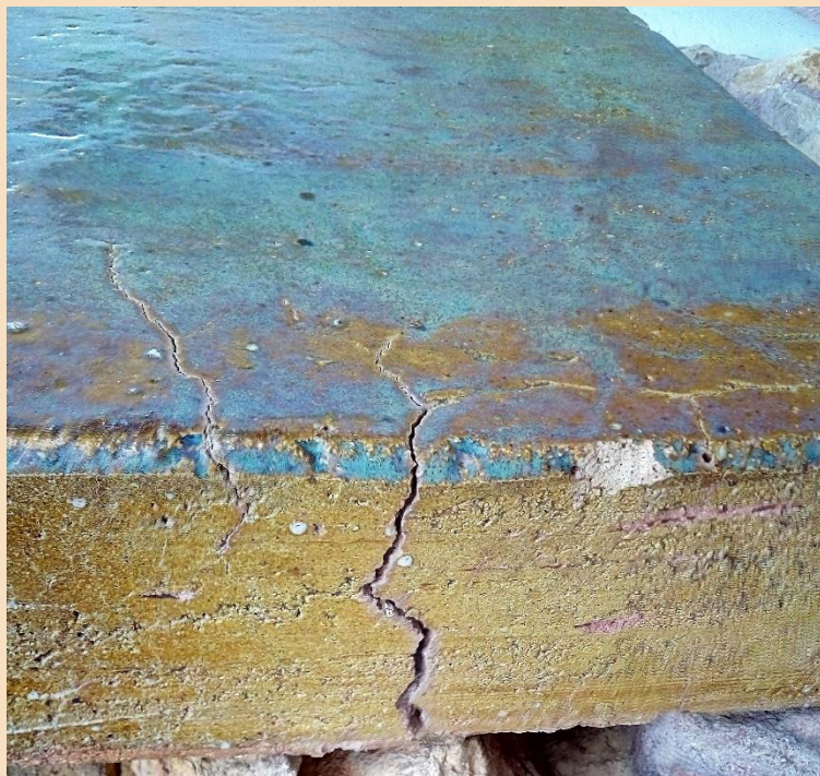
Figura 2. Grietas de soporte una pieza hueca moldeada por unión de placas. Fotografía: Rafa Galindo.
