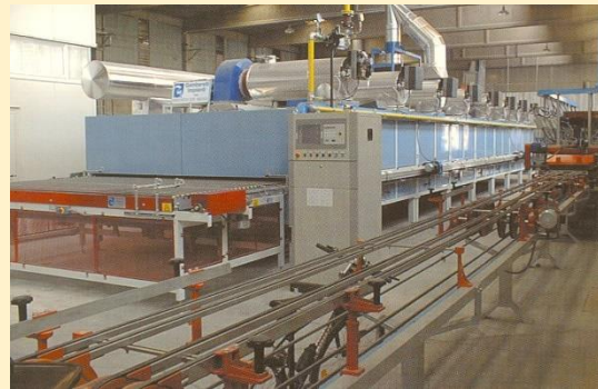
Figura 2. Secadero horizontal monocanal para baldosas cerámicas
