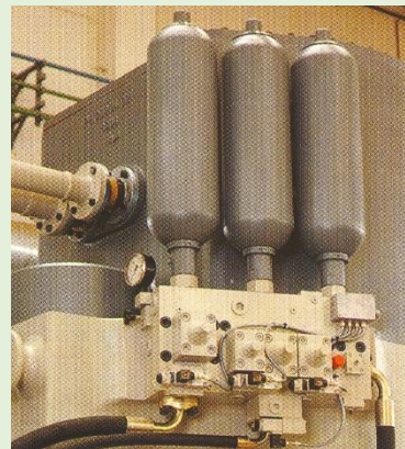
Figura 4. Acumuladores de presión.
